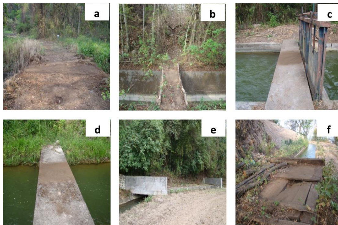
a：車行路橋 b：野生動物專用跨橋 c：水閘門跨板 d：混凝土跨橋 e：混凝土蓋板 f：木質蓋板
